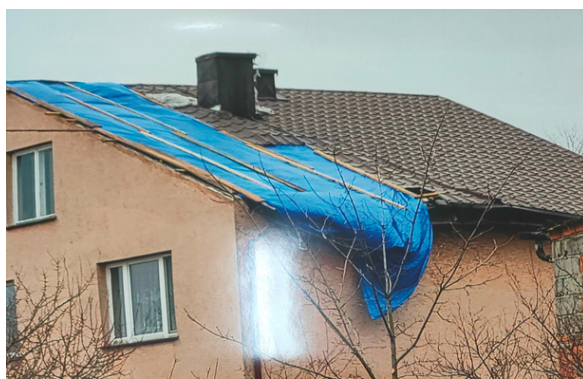
Dach zerwany podczas wichury
